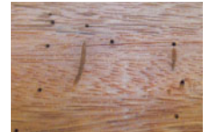
„Pinholes“ bei überseeischen Harthölzern
