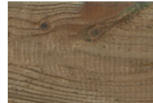
Rauhe Stellen auf der Holzoberfläche
