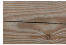
Spannungsrisse durch die Holz-trocknung
