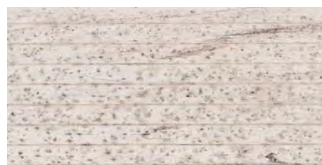
Stockflecken/Schimmel auf der Oberfläche
