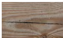
Spannungsrisse durch die Holz Trocknung
