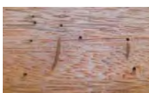
„Pinholes“ bei überseeischen Harthölzern
