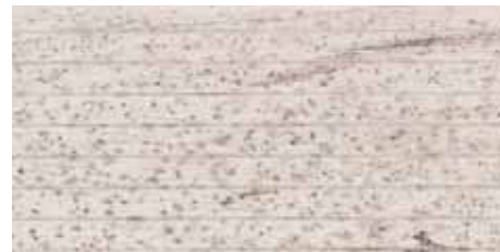
Stockflecken/Schimmel auf der Oberfläche
