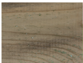
Stockflecken und leichter Schimmelbefall
