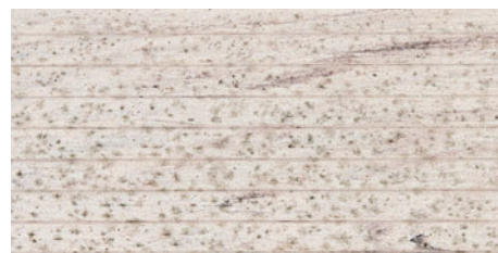
Stockflecken/Schimmel auf der Oberfläche
