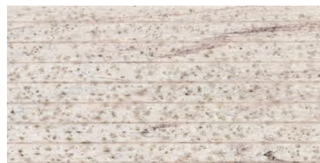
Stockflecken/Schimmel auf der Oberfläche
