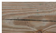
Spannungsrisse durch die Holz Trocknung
